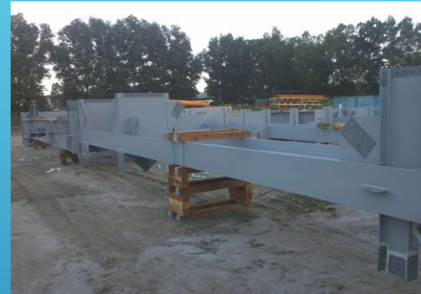
Nhiệt điện Vũng Áng / Vung Ang Thermal Power Plant
