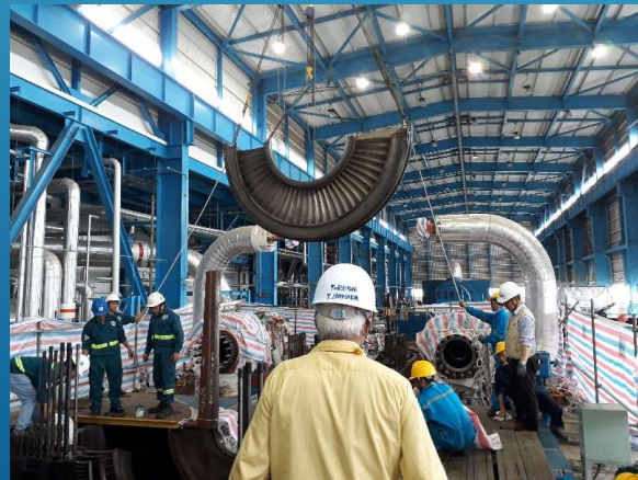
Nghiệm thu Turbine Nhiệt điện Ô Môn Tổ máy số 2 / Inspector of Turbine for O Mon Thermal Power Plant Unit No.2
